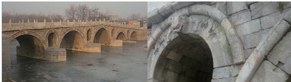
도 5-2 (좌) 중국 선교(單橋, 별칭 樂善橋). 하북 창현. 1364년 이전 조성; (우) 선교 세부. 호접형 요철 및 인면석두 썸기돌
