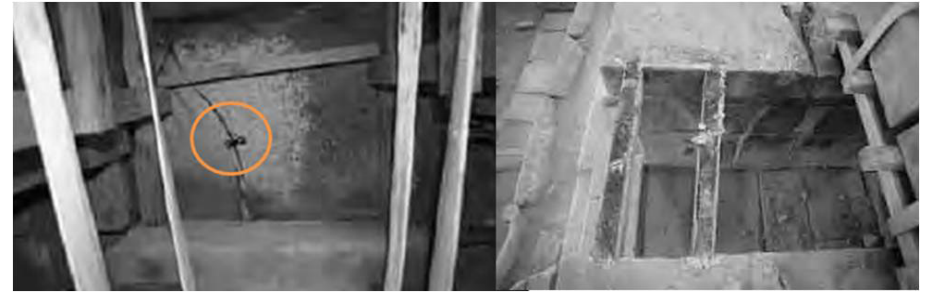
도 1-1 미륵사지 서탑. 백제 639년 조성. 통로 천장석 바닥면의 근대기 보강 호접형 은장(“나비장”(좌) 미륵사지 서탑. 기단 바닥면의 근대기 'I'자형 보강철물. 길이 방향으로 받혀놓은 상태로 발견(우)
